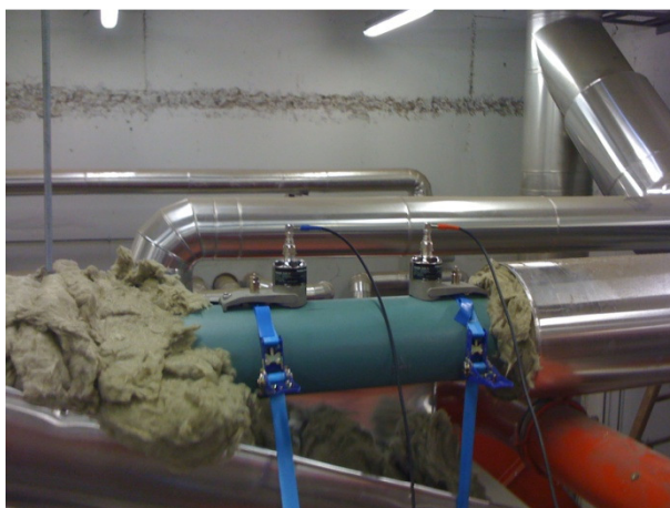
Slika 35 Mjerenje protoka na polaznoj cijevi generatora topline
