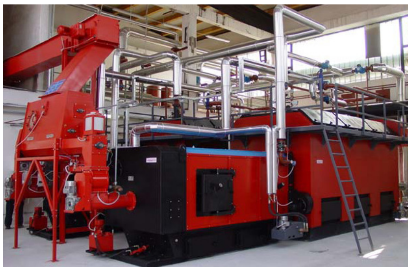
Slika 27 Postrojenje sa zasebnim ložištem i generatorom topline
